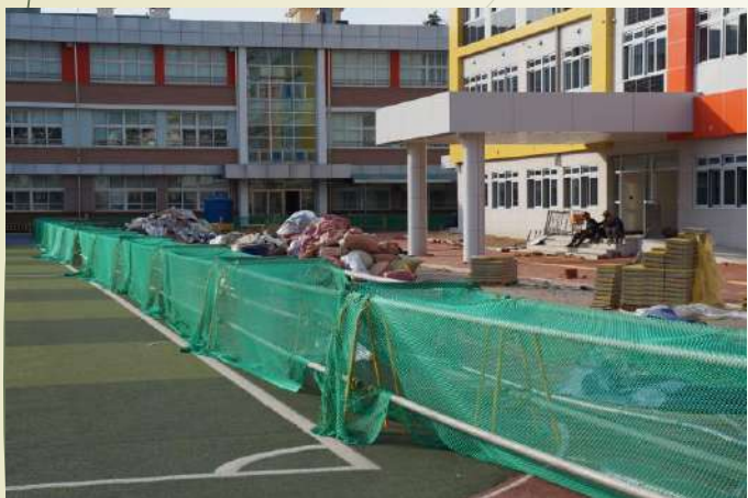
フンヘ小学校校舎 フェンスの向こうにがれきが残されたままになっている
